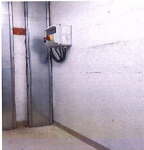
coffret de commande dans la zone escalier.
